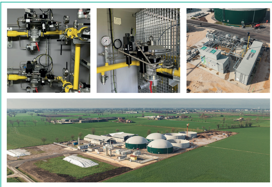
Figura 6 Estaciones de mejora e inyección de biogás (GNR)
