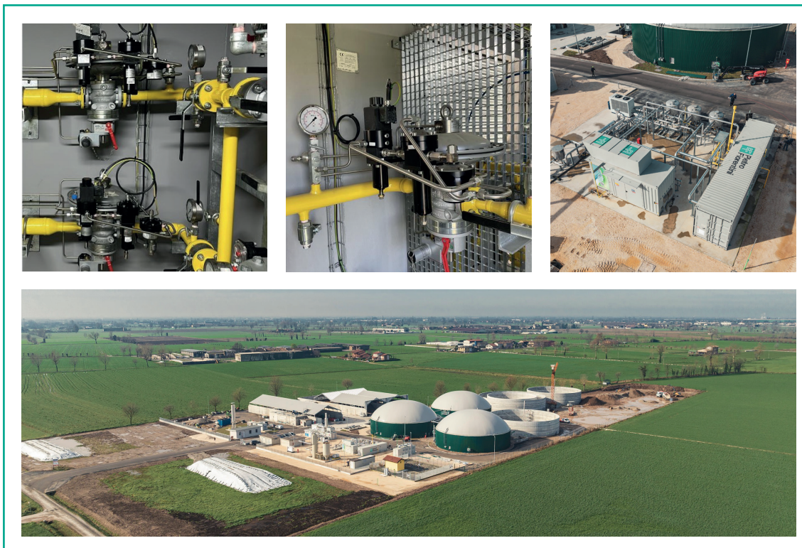
Figura 6 Stazioni di upgrading e iniezione di biogas (RNG)
